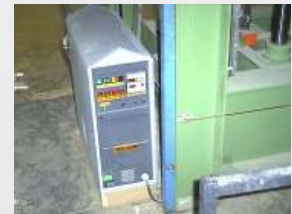
Beispiel Nachrüstung : Energiespeicher neben der Presse aufgestellt
