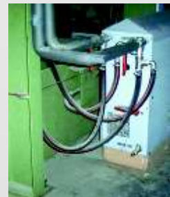
Beispiel Nachrüstung : Anschluß des Energiespeichers mit Zuleitung der kundeneigenen Heizungsrohre
