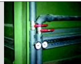
Beispiel Nachrüstung : Vorlauf-u.Rücklauf-temperaturüberwachung und Absperrschieber der kundeneigenen Heizung
